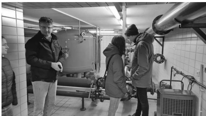
Im Grundwasserpumpwerk in Buch
